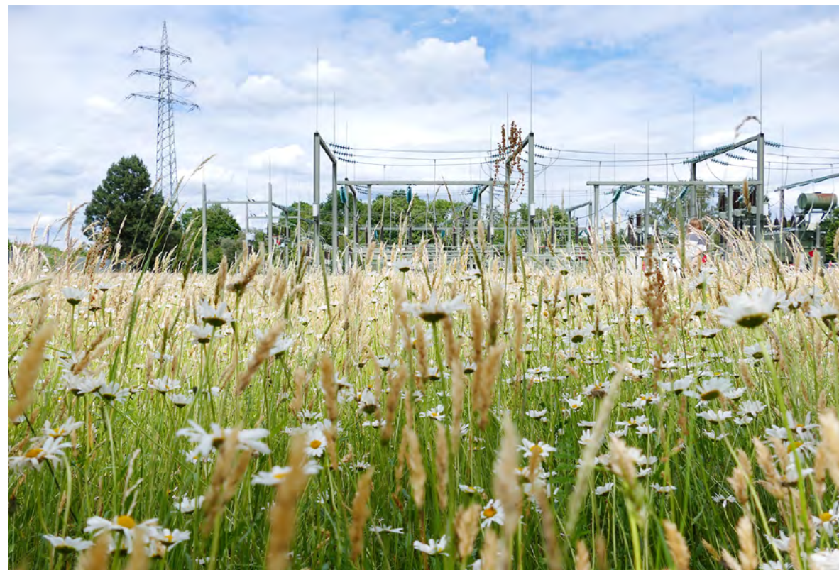
Unsere Umspannanlagen werden nach und nach ökologisch aufgewertet
